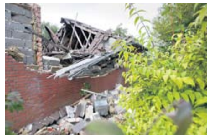
Det gamle mejeri brændte forrige påske. De nye ejere vil rive bagbygningen ned og lave en lejlighed i resten. Foto: Tommy Kofoed
